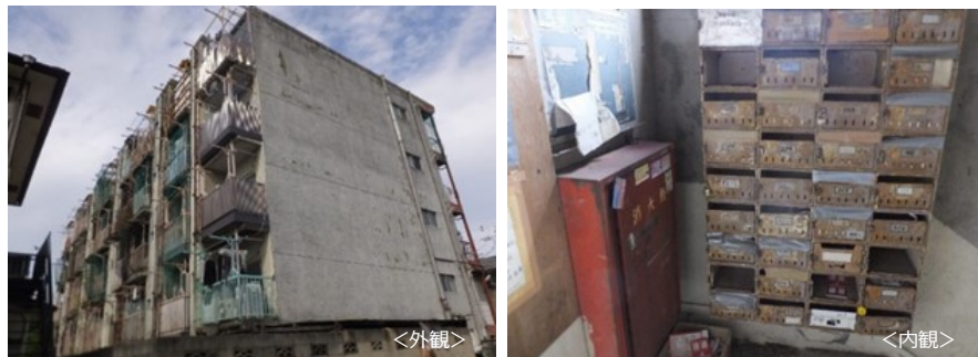
建物の傷みが著しく外壁の剥落、鉄骨の露出などが見られる事例
